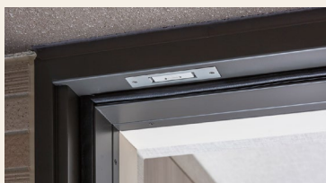
全住戸の玄関扉に設置した 防犯マグネットセンサー
